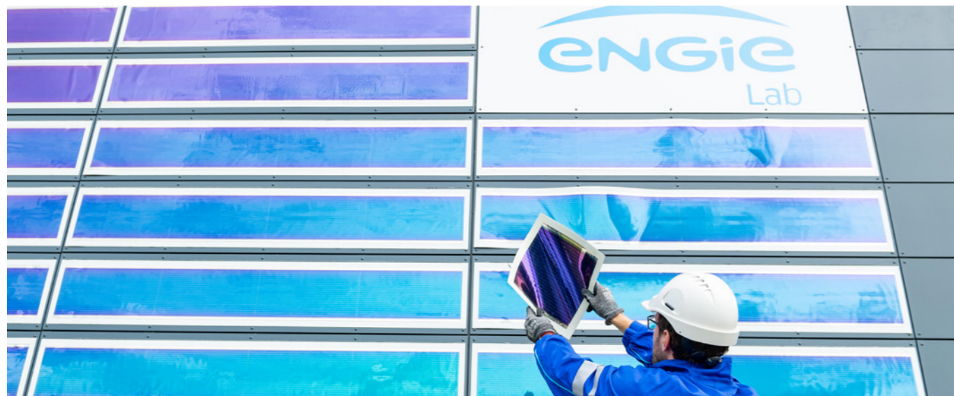
Modules PV légers Heliatek sur le bâtiment d'ENGIE Laborelec, Linkebeek, Belgique.
